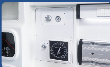
แผงควบคุมระบบออกซิเจน (แบบ Pipe Line)
